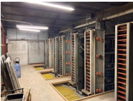
改造前の他社設備
