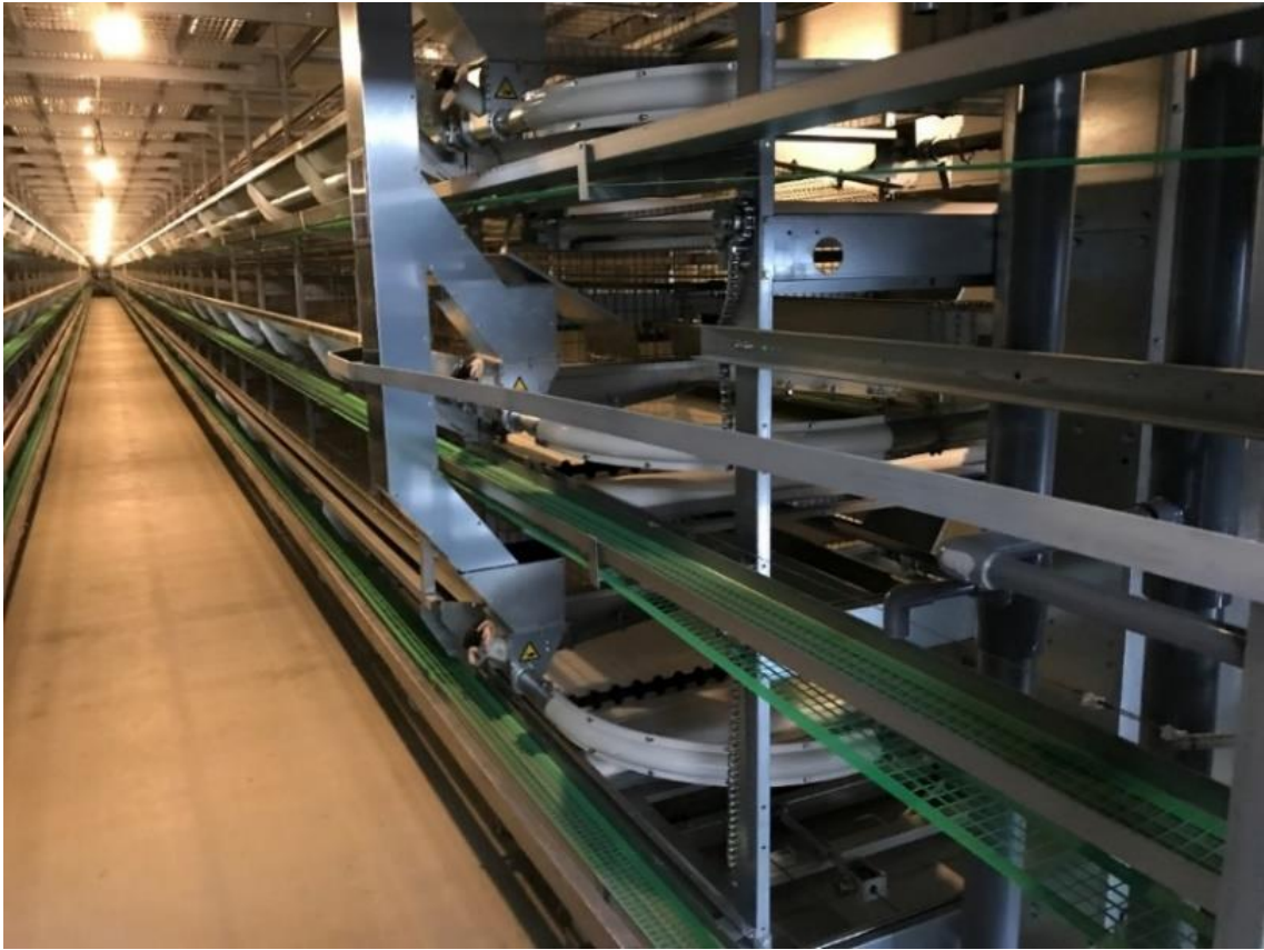
施工が完了した鶏舎内部設備です
