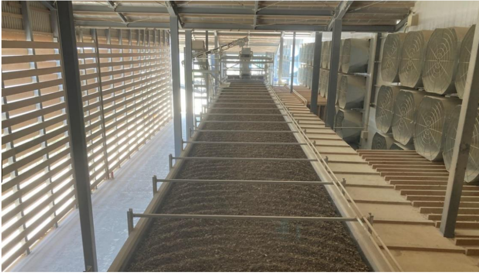
大量の鶏糞が投入され、乾燥運転中のプレートドライヤー
